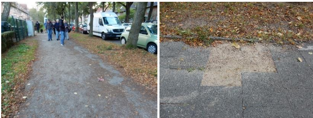
Abbildung 41: Wiener Allee (links unbefestigter Gehweg mit Beleuchtung; rechts befestigter Gehweg mit Stolperkanten ohne Beleuchtung)
