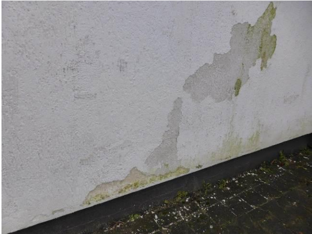
Abbildung 40: Detailansicht der schadhaften Außenwand
