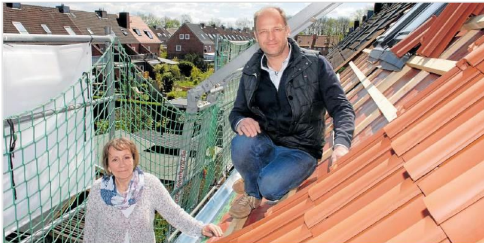
Ulrike Kirmse (li.) in der Karlsbader Straße freut sich über ein saniertes Dach. Bei der Renovierung hielt sich Dachdeckermeister Patrick Leonhardt an die Vorgaben des Förderprogramms für energetische Sanierungen. FOTOS: KARIN JORDT
